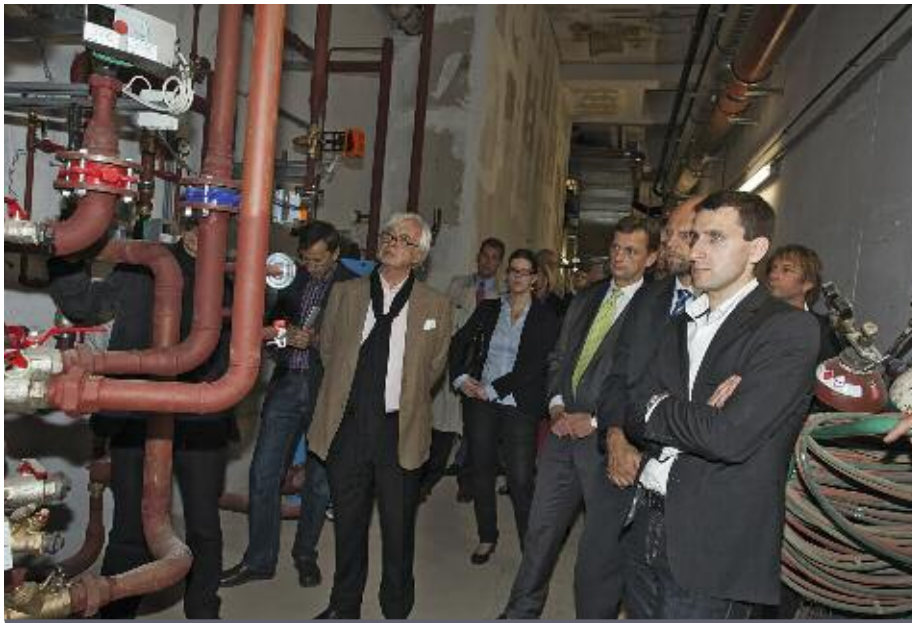
Jede Menge Gebäudetechnik und fast schon zu wenig Platz für die interessierten Gäste
